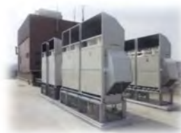
高効率空調設備室外機
